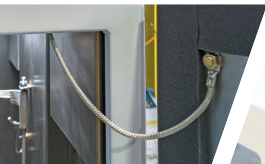
Mise à la terre
